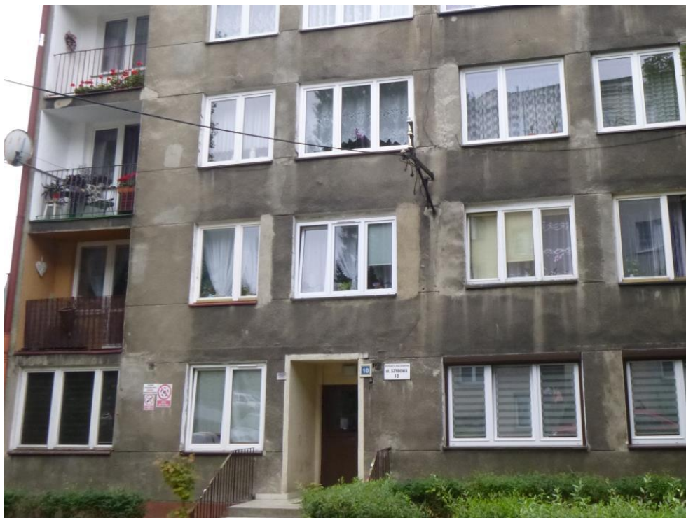
Rys. 11. Zabrudzenia i przebarwienia na powierzchni elewacji [1.4].
