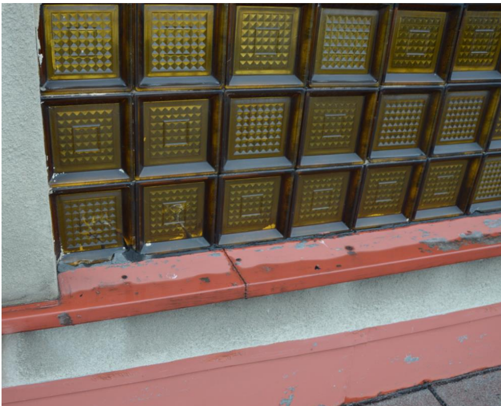
Rys. 14. Uszkodzenia mechaniczne luksferów oraz obróbki blacharskiej [1.4].
