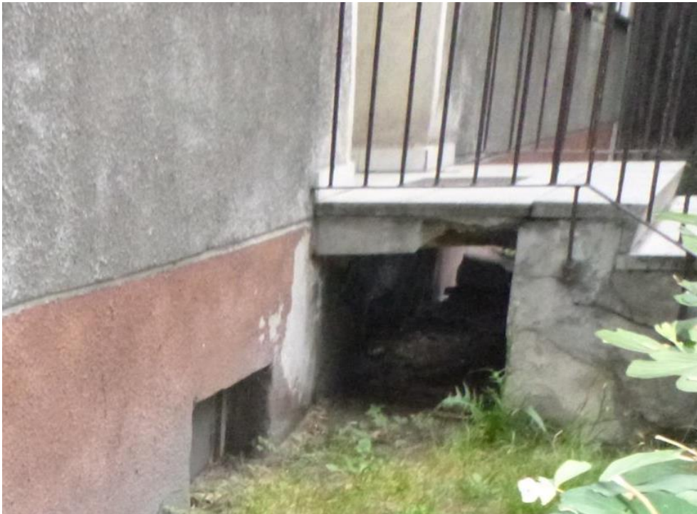
Rys. 13. Uszkodzone powierzchnie boczne i spód schodów przed wejściem. [1.4].
