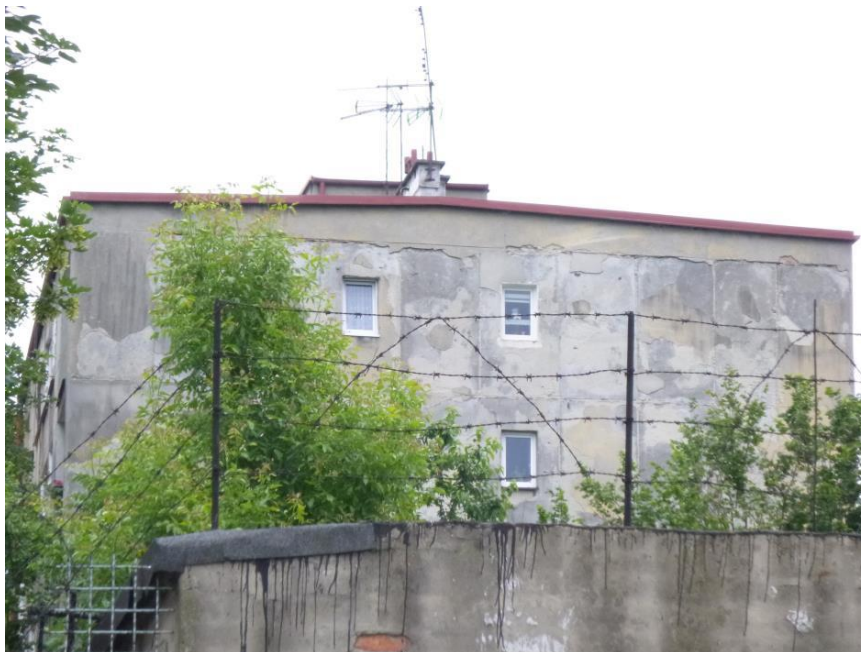
Rys. 7. Odspojenia tynku na elewacji bocznej [1.4].
