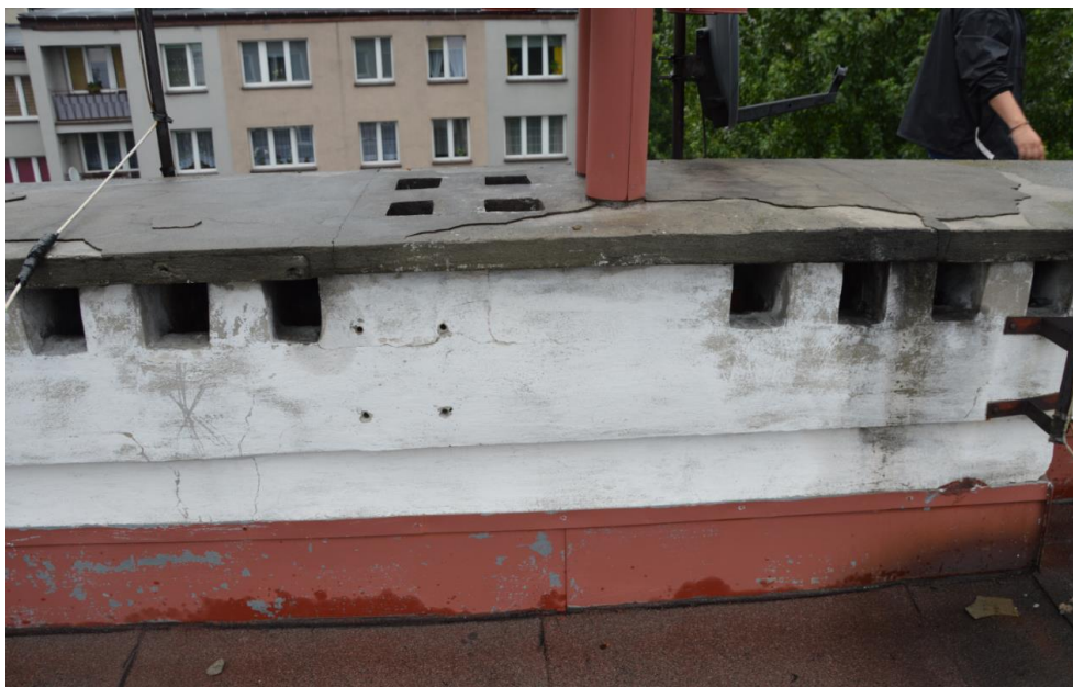
Rys. 15. Uszkodzenia mechaniczne luksferów oraz obróbki blacharskiej [1.4].
