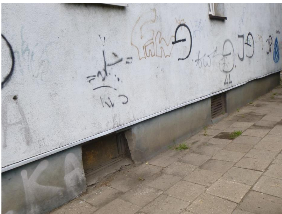
Rys. 12. Zdeprawiona elewacja szczytowa [1.4].
