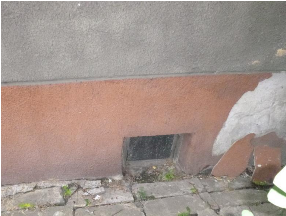
Rys. 9. Odspojenia tynku i zawilgocenia w strefie cokołowej [1.4].
