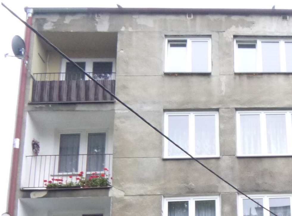
Rys. 10. Zabrudzenia i przebarwienia na powierzchni elewacji [1.4].
