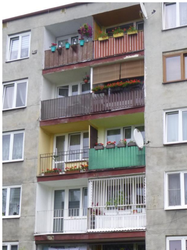
Rys. 8. Odspojenia tynków i powłok malarskich, korozja obróbek blacharskich balkonów [1.4].
